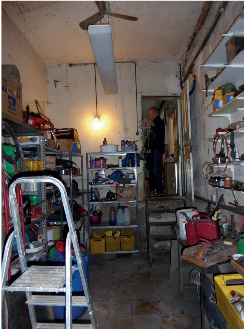
Abbildung: Hausanschlussraum mit Treppe zur Wohnung des Hausmeisters
